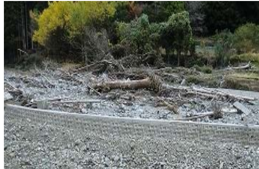
寺内ダム上流の被災状況
