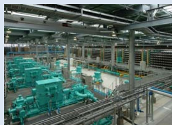
海水淡水化センター施設内部
