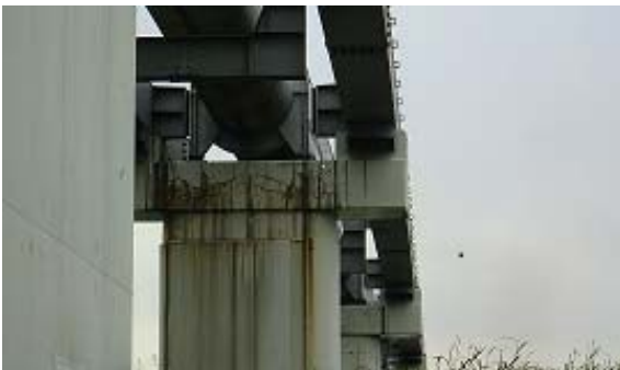
思案橋水管橋の劣化の現状（ひび割れ）
