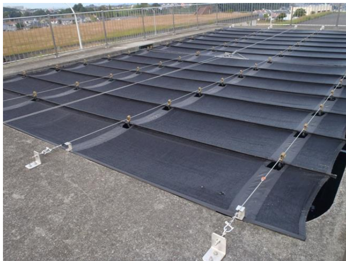
写真 2 ろ過池遮光ネット
