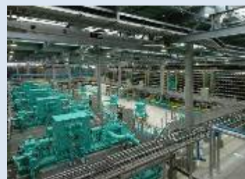
海水淡水化センター施設内部
