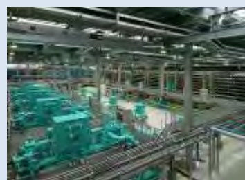
海水淡水化センター施設内部
