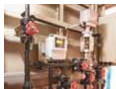
⑥消毒薬混和池
