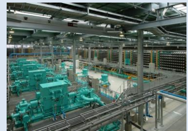
海水淡水化センター施設内部
