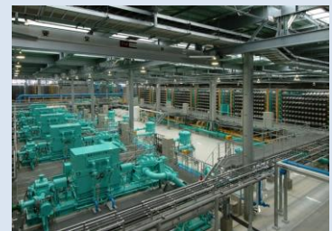
海水淡水化センター施設内部
