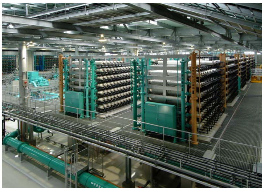
図－60 海水淡水化センター内部（膜の配置状況）
