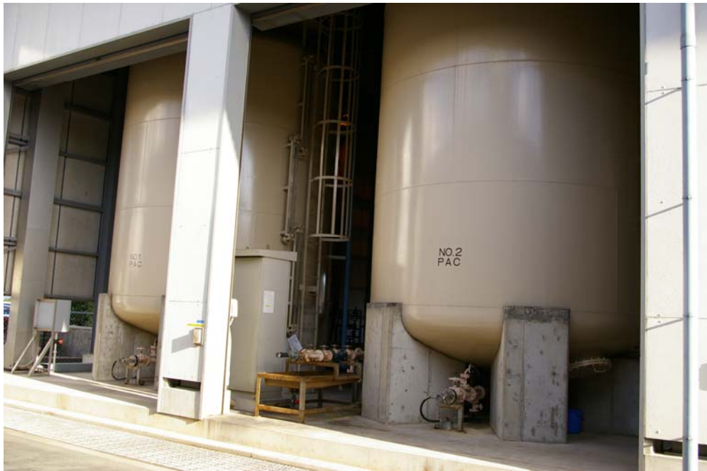
図-12 ポリ塩化アルミニウム※ 26 （PAC）の備蓄タンク（牛頸浄水場）
