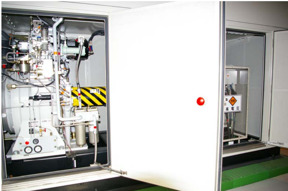
図-13 非常用発電設備（牛頸浄水場）
