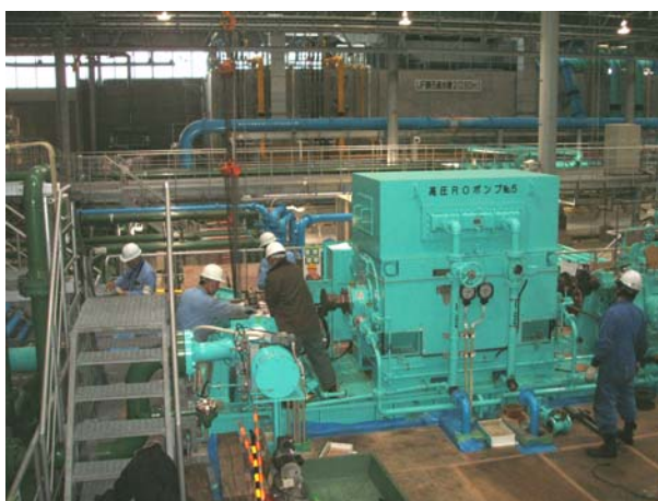
図-35 高圧 RO ポンプの点検状況(海水淡水化センター)
