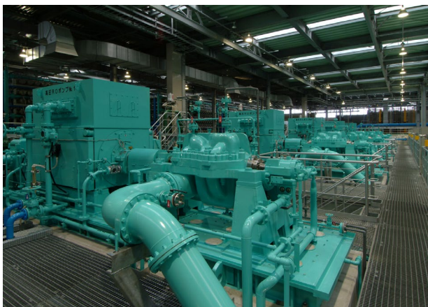
海水淡水化施設内部（高圧 RO ポンプ）
