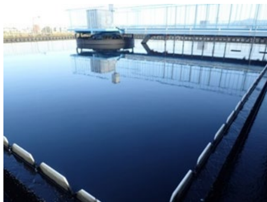
濃縮槽の様子
