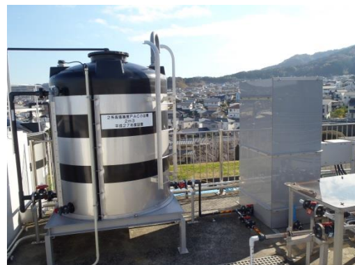
写真 2 H27 実証試験用 PAC 注入タンク
