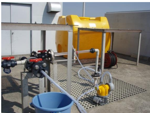
写真 1 H26 仮設 PAC 注入設備
