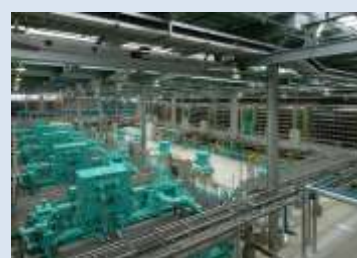
海水淡水化センター施設内部
