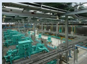
海水淡水化センター施設内部
