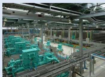
海水淡水化センター施設内部
