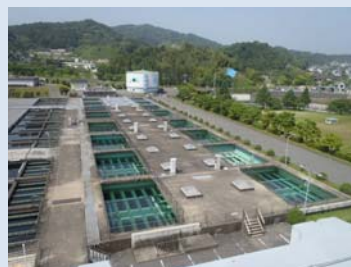
牛頸浄水場急速ろ過池
