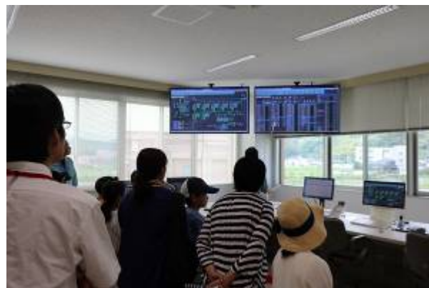
東隈浄水場の中央監視室
