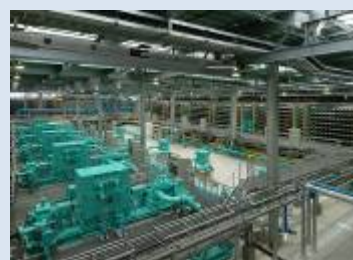
海水淡水化センター施設内部
