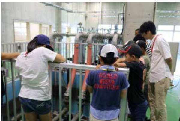
東隈浄水場の膜ろ過設備
