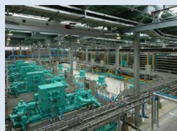
海水淡水化センター施設内部
