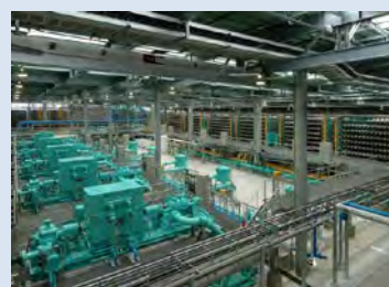
海水淡水化センター施設内部
