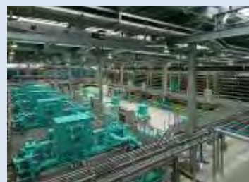
海水淡水化センター施設内部
