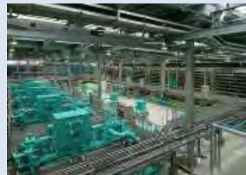
海水淡水化センター施設内部
