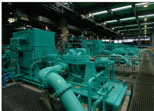
高圧 R0 ポンプ設備
