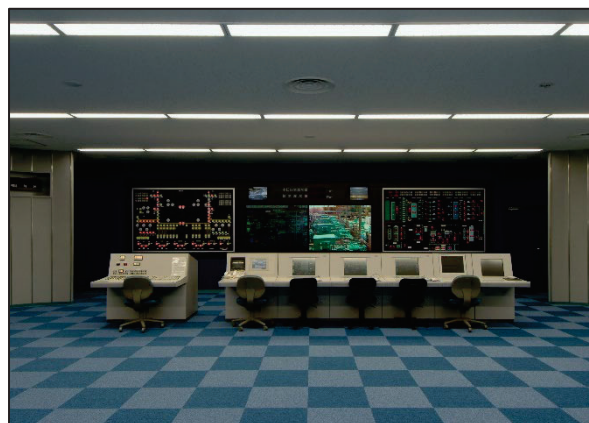
中央監視設備
