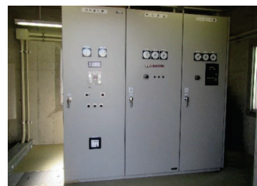
天拝坂中央配水池 電気設備
