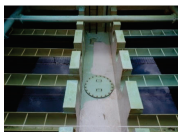
牛頸浄水場 ろ過池
