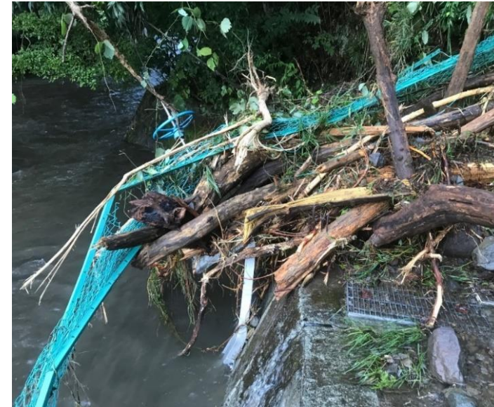
令和元年台風第19号による取水門の被災状況 （神奈川県南足柄市（約6,900戸断水））
