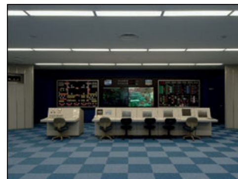
監視制御設備
