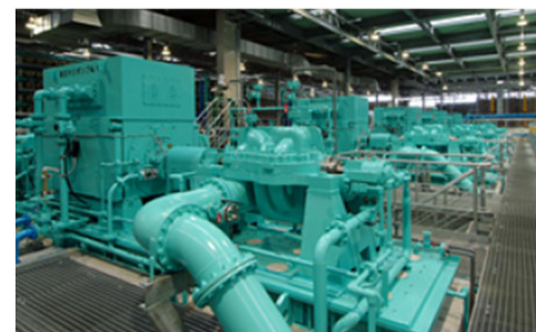
高圧ROポンプ設備
