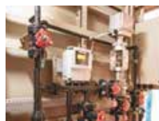
⑥消毒薬混和池
