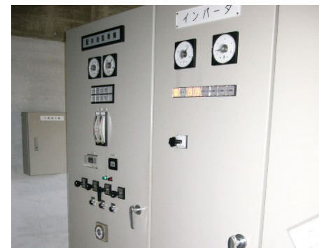
天拝坂中央配水池電気設備
