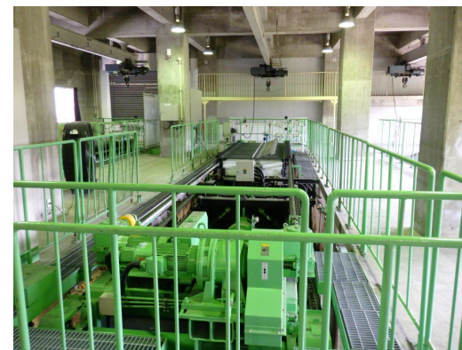
牛頸浄水場 脱水機
