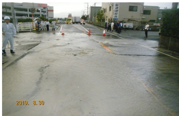
図 2-10 下原系送水管漏水事故
