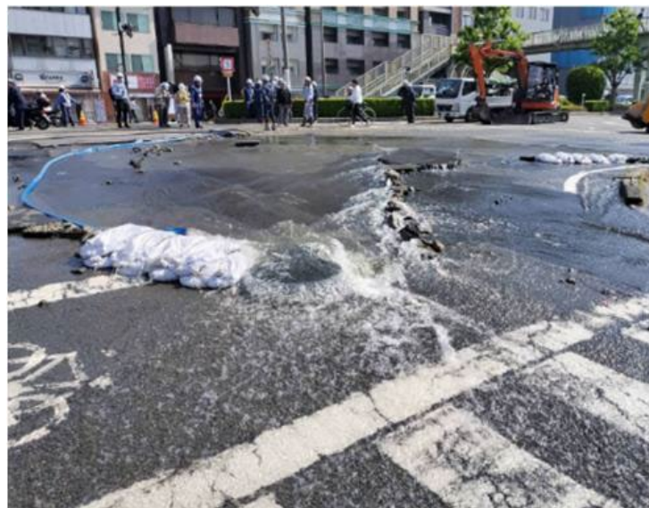
老朽化による管の破損に伴う漏水 (京都市)
