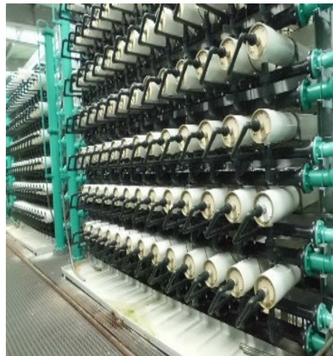
処理工程から省略したUF膜 （海水淡水センター）
