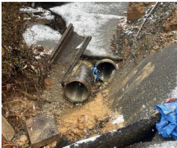
能登半島地震による送水管損傷 (輪島市)
