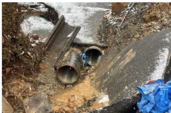
写真-9 能登半島地震による 送水管損傷（輪島市）
