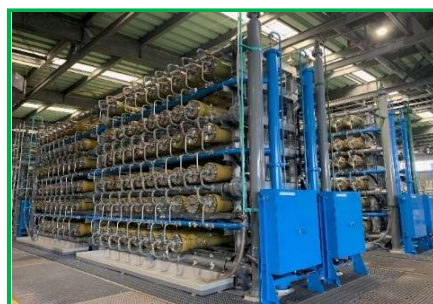
写真-5 高圧RO膜設備の更新（海淡水施設）
