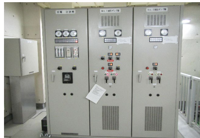
粕屋南ポンプ場電気設備
