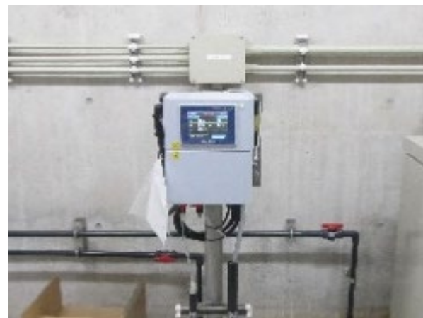
水質計器（塩素濃度を測定する計器）
