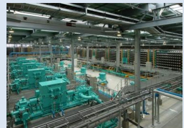
海水淡水化センター施設内部
