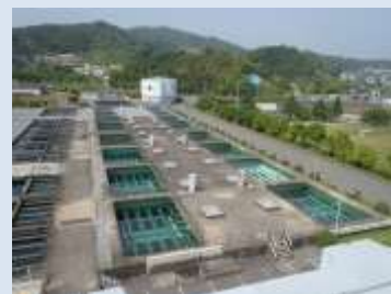
牛頸浄水場急速ろ過池
