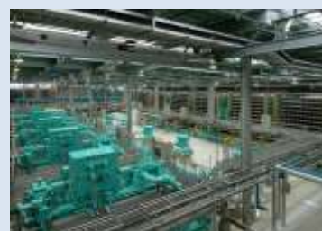
海水淡水化センター施設内部
