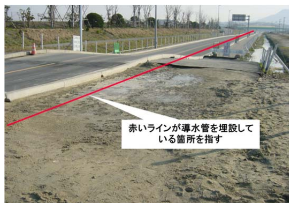
地震により道路とともに導水管が隆起（布設替えにより復旧）
