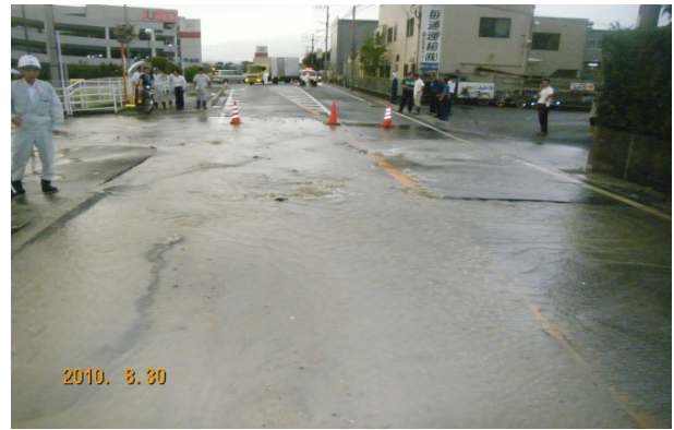
図 2-10 下原系送水管漏水事故
